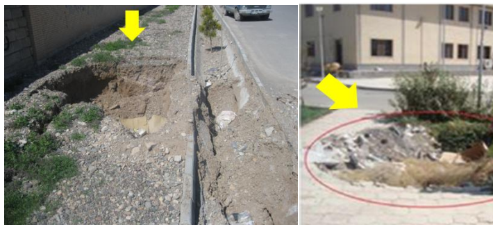
شکل ۱۰. فروریختن و ایجاد حفره در خاک
