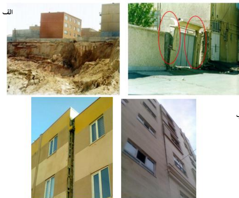
شکل ۳. نمونه‌هایی از مشکلات سازه‌ها در خاک‌های رسی شهر تبریز، الف) نشست و ناپایداری، نگین پارک [۲۴]، ب) انحراف سازه در اثر نشست، باغمیشه و ارم
