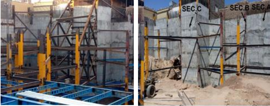
شکل ۱۰. الف) آسیب‌های وارده به ساختمان ۳ طبقه مجاور گود در مقطع C، ب) حفاری در مقطع C بدون نصب مهارهای کافی و افزایش روند صعودی تغییر شکل‌ها، ج) نصب مهارهای اضافی برای جلوگیری از افزایش تغییر شکل‌ها در مقطع C
