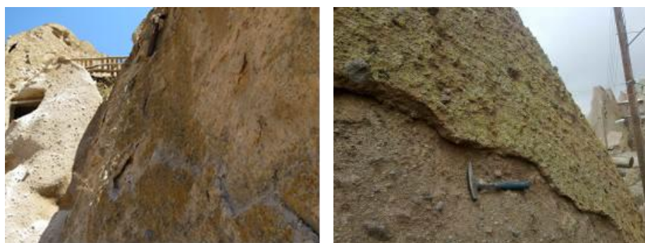
شکل ۱۳. هوازدگی و تخریب سطوح مخروط‌های سنگی کندوان
