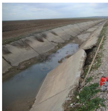
شکل ۱. نمایی از محدوده آزمایش خاک واقع در کانال‌های اصلی شبکه سد بوستان گنبد و خرابی‌های رخ داده شده در آن
