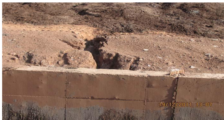
شکل ۲. خرابی موجود در مجاورت کانال انتقال آب سیمین‌دشت به گرمسار
