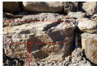
تخریب فیزیکی ناشی از هوازدگی نمک
