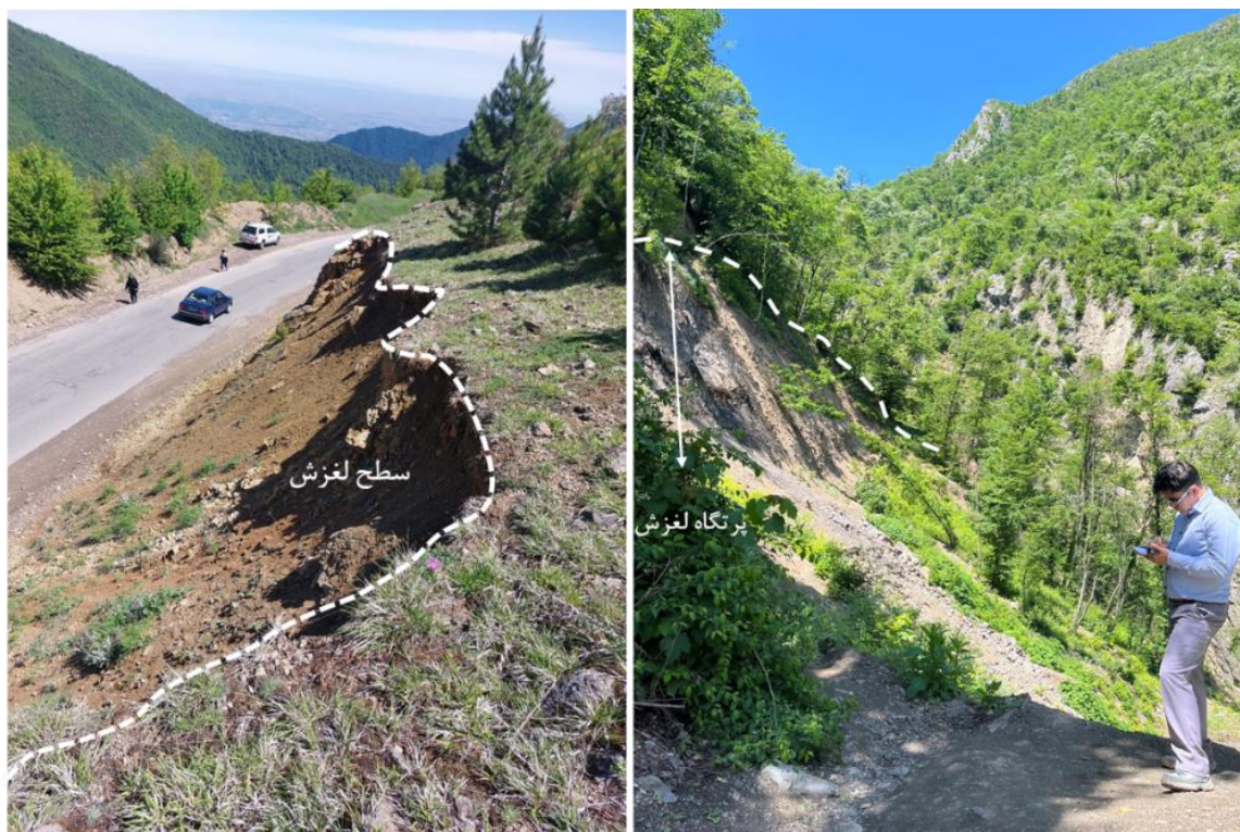
شکل ۱. تصاویری از برخی لغزش‌های رخ داده در مجاورت جاده توسکستان Fig. 1. Photographs of landslides that occurred in the vicinity of Tuskestan
