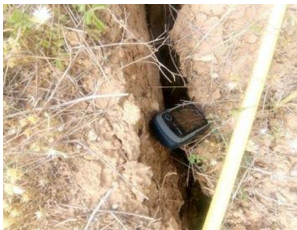
شکل ۱۱. تصاویری از ایجاد شکاف کششی در تاج شیب و آسیب ناشی از آن به سازه‌ها در پروفیل B Fig. 11. Images of tensile crack formation at the slope crest and the resulting damage to structures in Profile B
