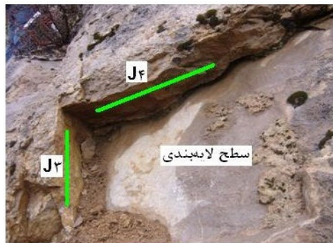
شکل ۸. سیستم درزه‌های J 3 ، J 4 و لایه‌بندی
