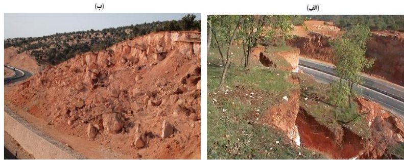
شکل (۲) لغزش داد آباد در ترانشه های مشرف به جاده بر اثر جاده سازی، کیلومتر ۲۲ جاده مطالعاتی، دید به جنوب غرب (الف)، لغزش آب بید به طول ۳۲۰ متر در دامنه های مشرف به جاده که باعث تغییر مسیر اصلی جاده و ایجاد پیچ تند شده است، دید به شمال شرق (ب)
