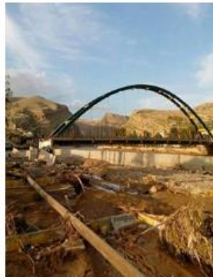
شکل (۴). رودخانه کشکان در پلدختر بعد از سیل
